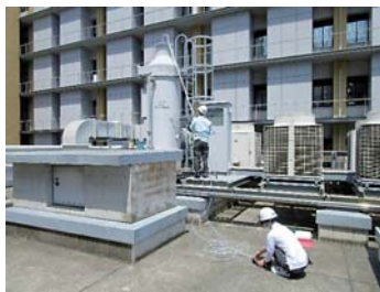
屋上に設置の排ガス処理装置出口における排ガス測定の様子
