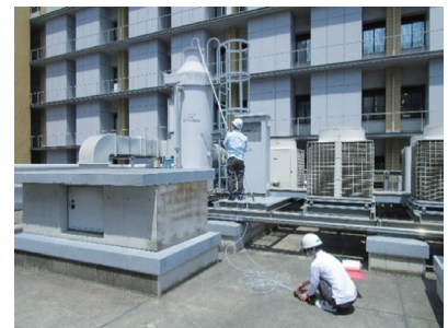
▲ 屋上に設置の排ガス処理装置出口における排ガス測定の様子
